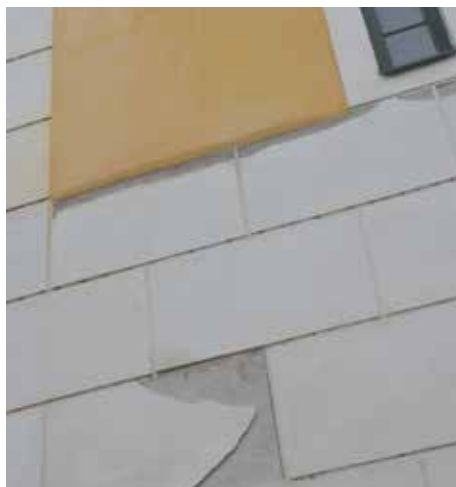
Schäden machen eine Renovierung nötig
